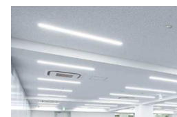
LED照明器具へ更新
