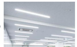
LED照明器具へ更新
