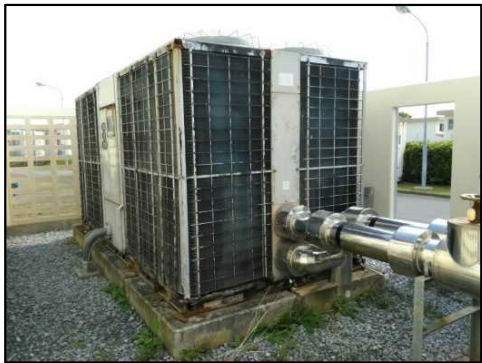
【老朽化した空調設備】
