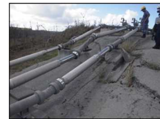
硫黄島のパイプライン破損状況
