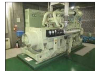
非常用発電機 (イメージ)
