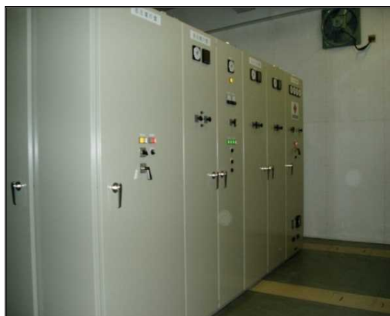
屋内キュービクル
