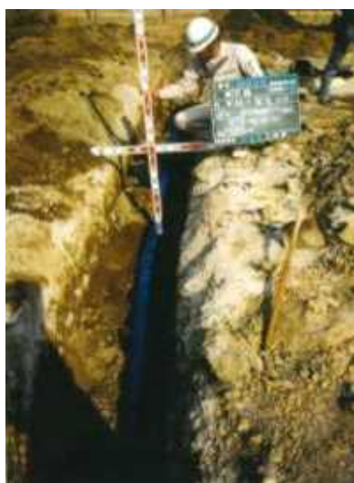
給水管の埋設表示
