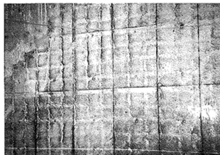
⑮型枠バイブレーターのかけ過ぎによる模様 2)
