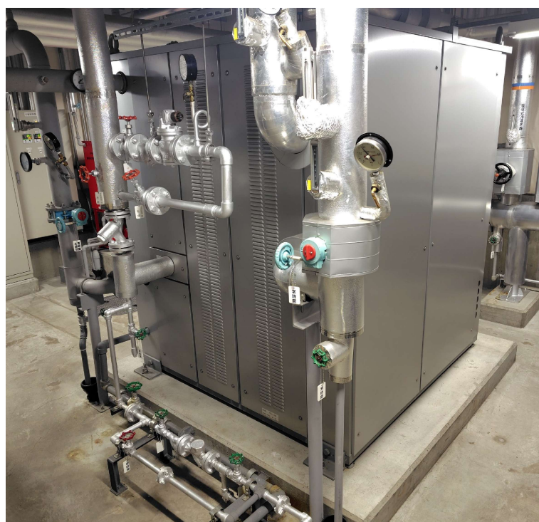
5 2 号 吸収式冷温水機
