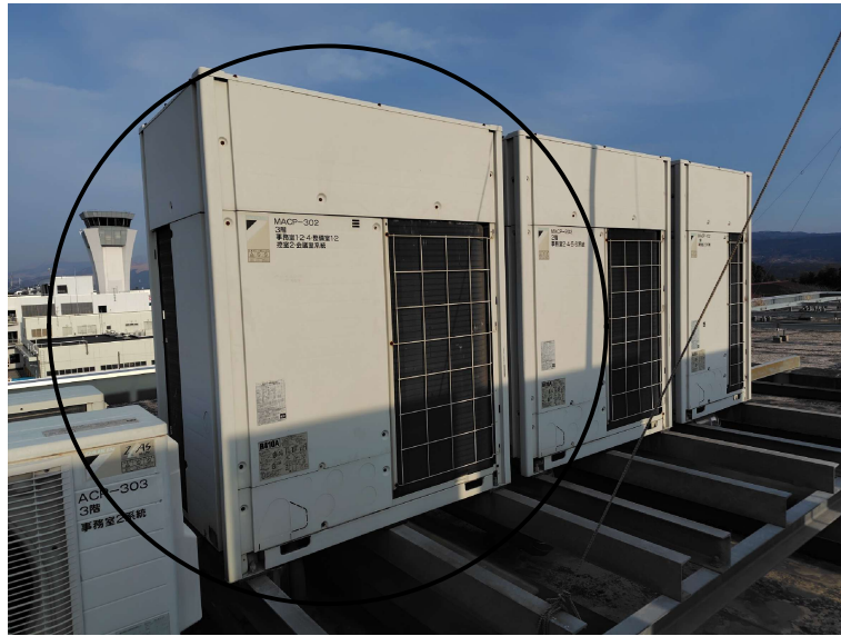
6 5号建物 室外機 屋上設置状況
