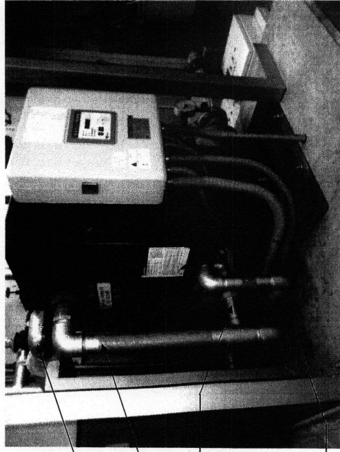
No.96号建物消火ポンプ現況写真②
