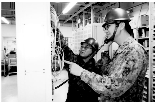
回線操作盤を操作して回線構成中
