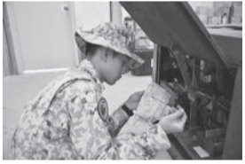
動力部の機能点検をする発電機整備陸曹
