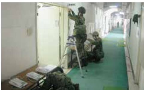
不測事態時の電話機を設置する様子
