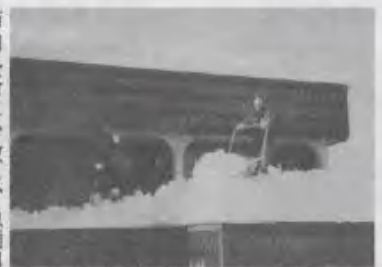
屋根の雪下ろし（三笠市）
