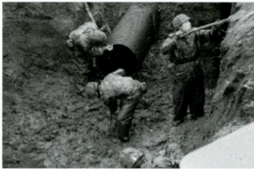
降雨と排水不良によりぬかるんだ現場
