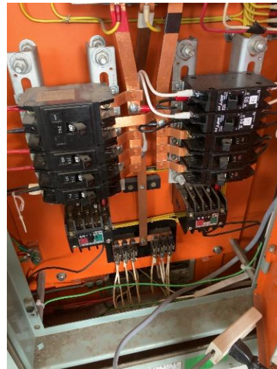
既設分電盤盤内下部
