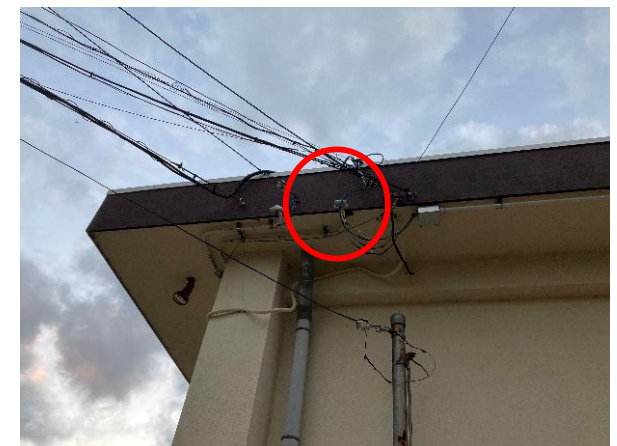
電線引込箇所
