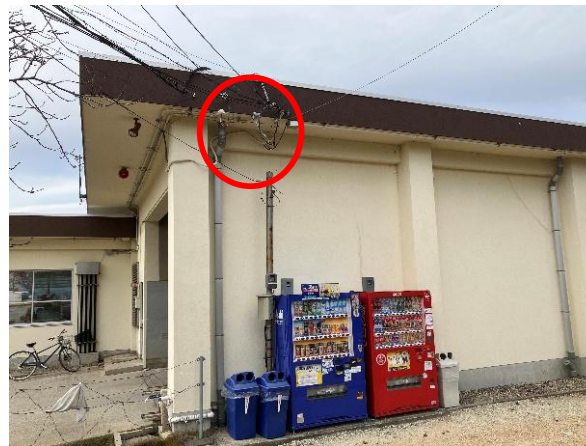
電線引込箇所
