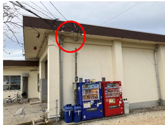
電線引込箇所
