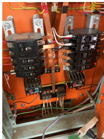
既設分電盤内下部
