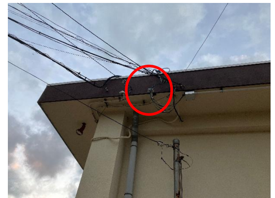
電線引込箇所
