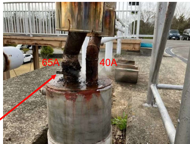
ピンホール発生箇所
