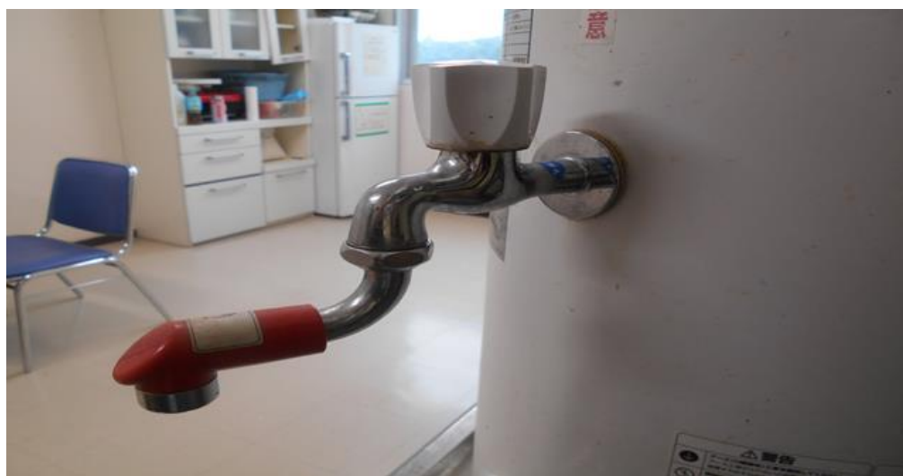
熱湯吐水管部
