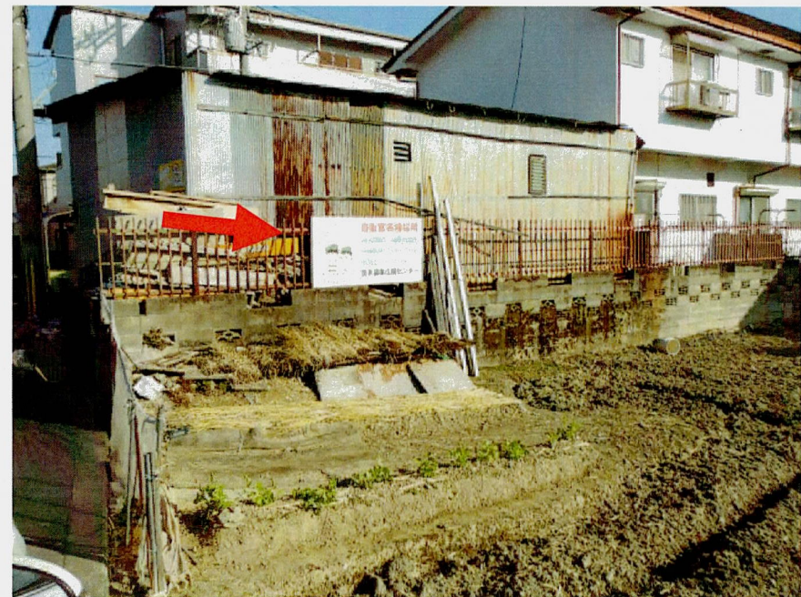
全体的な設置状況の分かる写真
