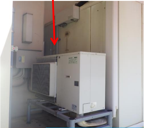
室外機から異音が生じ、ブレーカーが落ちてしまう
