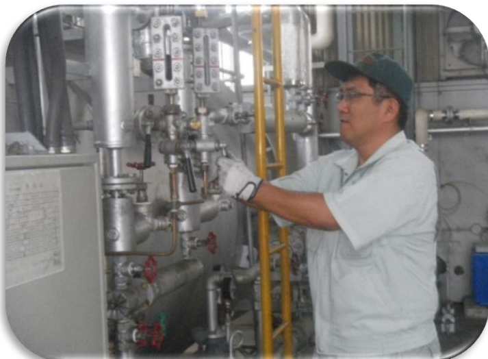
▲海田市駐屯地でボイラーの故障に対応する小林技官
