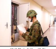
端子盤の点検・操作
