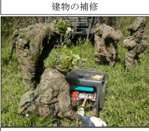
発電機の始動不良故障整備
