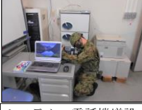
システム・電話機増設
