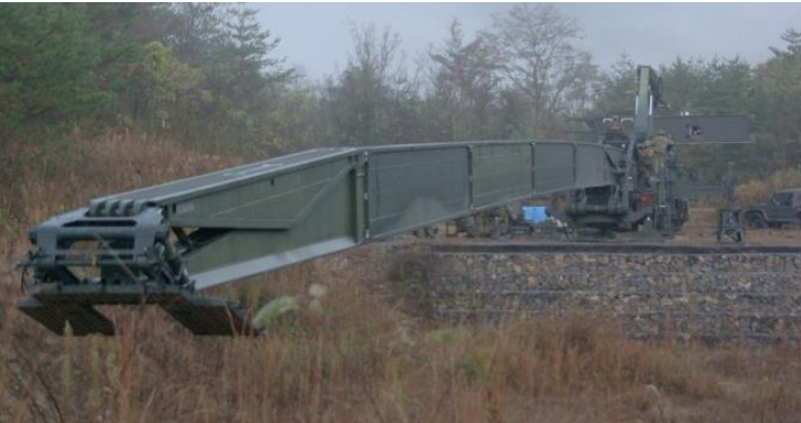
ガイドビームにより橋の基盤を架設する様子 (ビーム架設)
