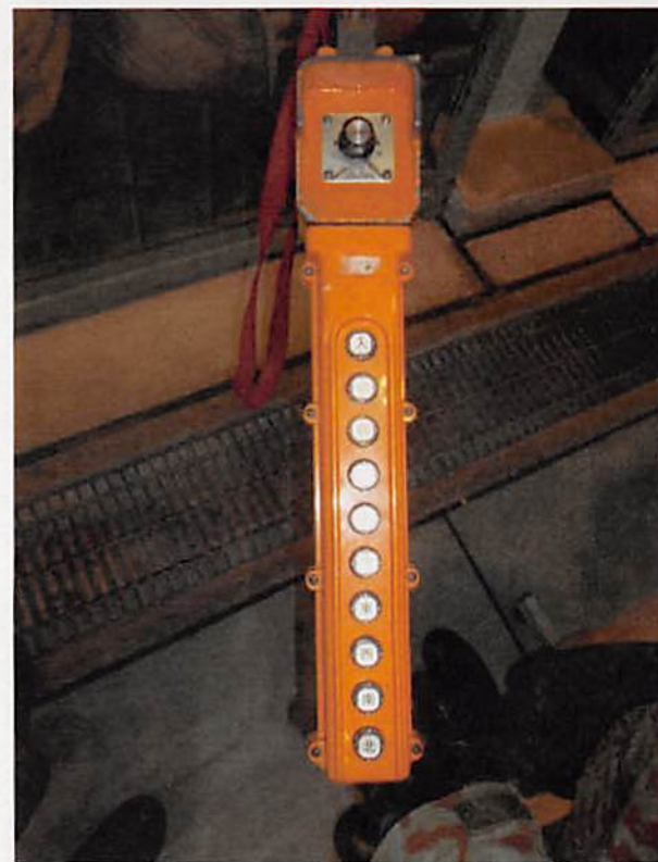
クレーン操作部
