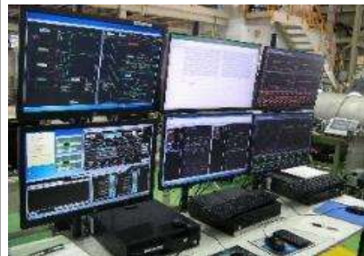
試験制御装置
