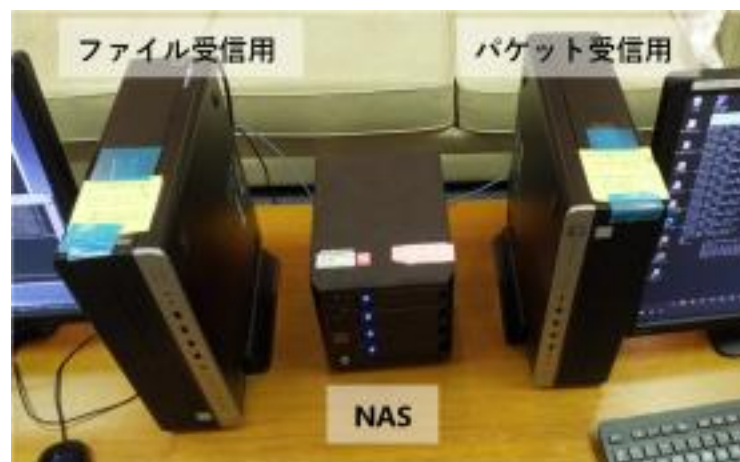
図 2.13 システムを稼働させる機器
