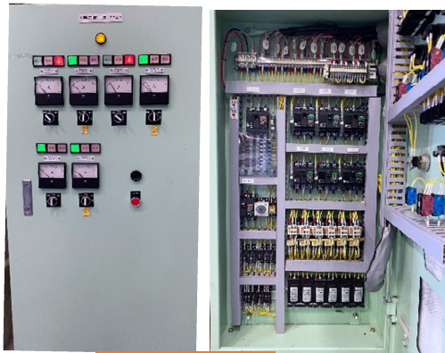
動力操作盤P-2 交換対象
