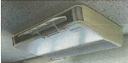
既設エアコン（室内機）
