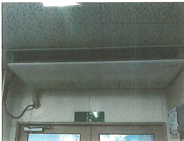
既設空調機（室内機）
