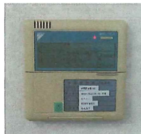
既設エアコン（リモコン）
