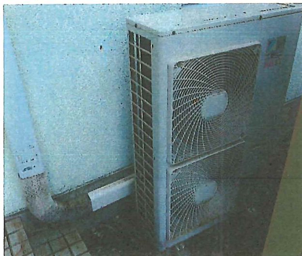
既設空調機（室外機表）
