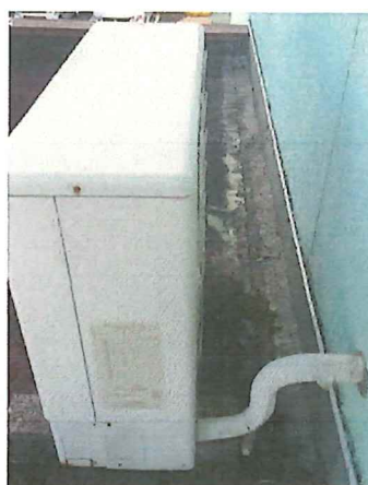
既設エアコン（室外機裏）
