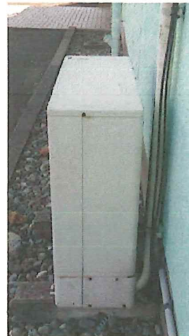
既設エアコン（室外機裏）
