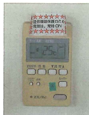
既設エアコン（リモコン）
