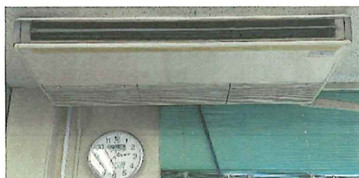
既設エアコン(室内機)
