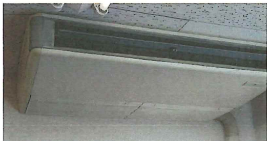
既設エアコン（室内機）
