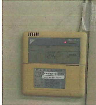
既設エアコン（リモコン）
