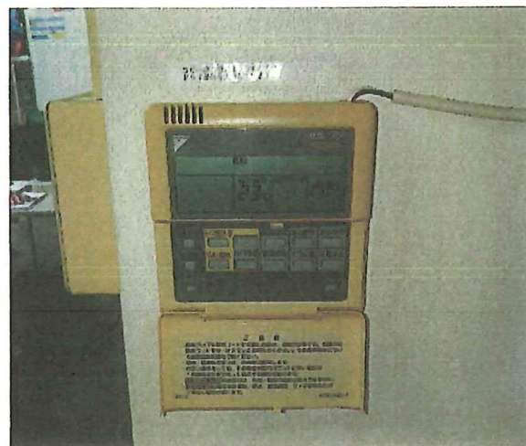
既設空調機（リモコン）
