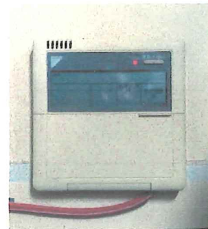
既設空調機(リモコン)
