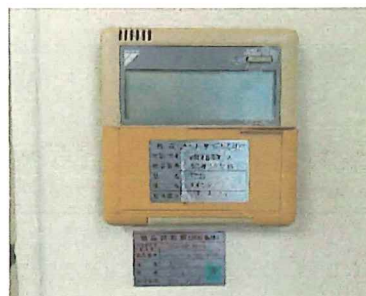
既設エアコン(リモコン)
