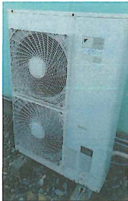
既設エアコン（室外機表）
