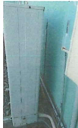
既設エアコン（室外機裏）
