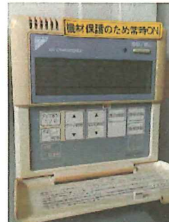
既設エアコン（リモコン）
