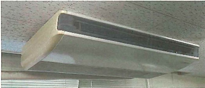
既設エアコン（室内機）
