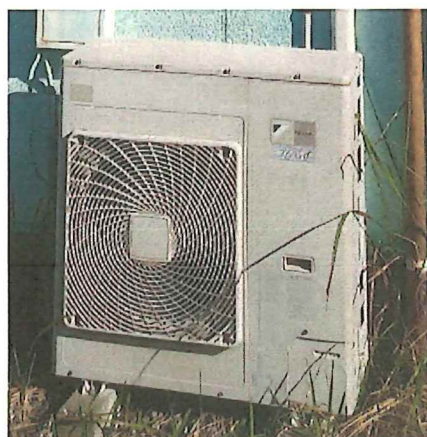
既設エアコン（室外機表）
