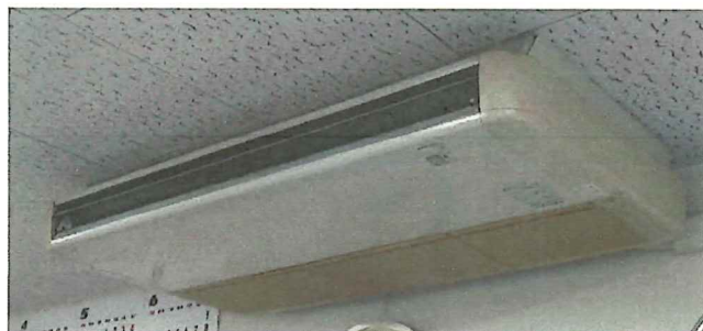
既設エアコン（室内機）
