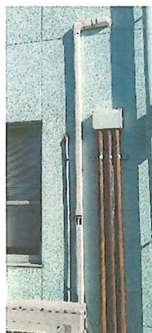
既設エアコン（配管）
