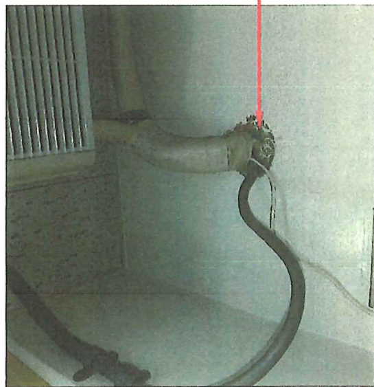
空調配管（貫通孔再利用）
