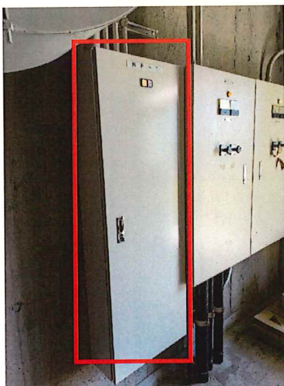
動力制御盤 外観
