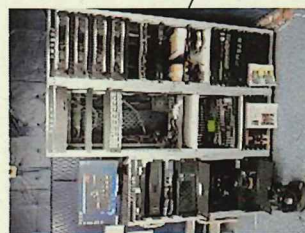
全天周シアター制御装 置・音響制御装置
