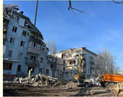
露軍のミサイル攻撃により破壊されたザポリジヤ市の集合住宅 (2023年3月) 【ウクライナ緊急事態庁】
