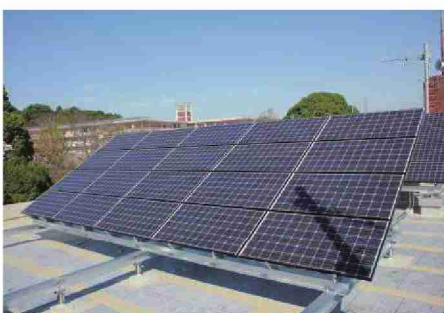
庁舎屋上に設置された太陽光発電システム
