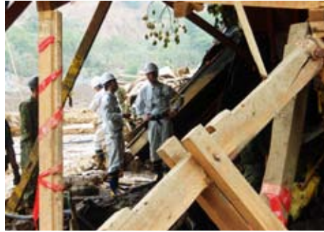
△ 被災状況の確認 (駒の湯温泉)
