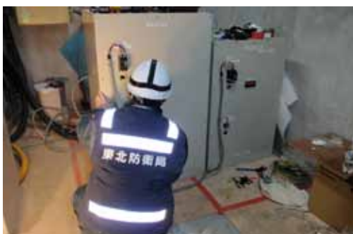
レンタルされた電源装置
