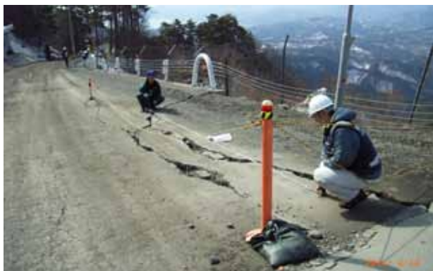
進入路の路肩のひび割れを調査(山田分屯基地)
