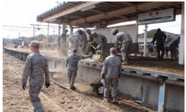
瓦礫等の撤去作業がほぼ終了した野蒜駅
