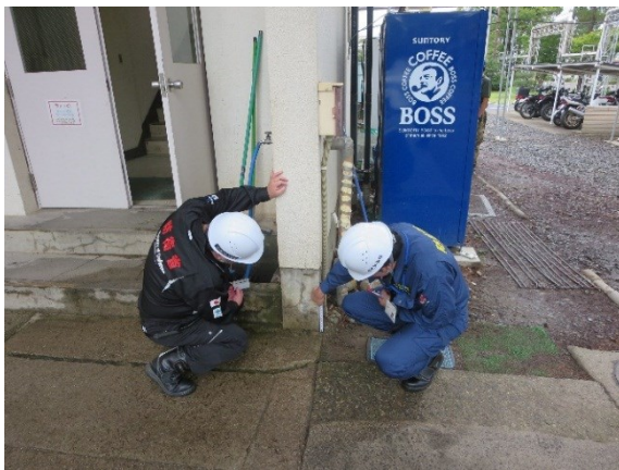
建築物の沈下を調査
