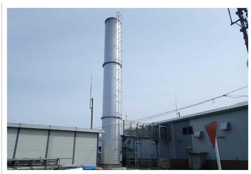
ボイラー煙突
