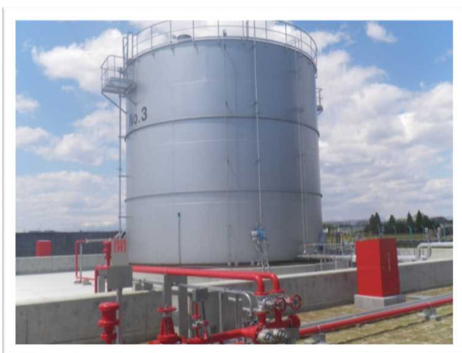
新設航空燃料タンク
