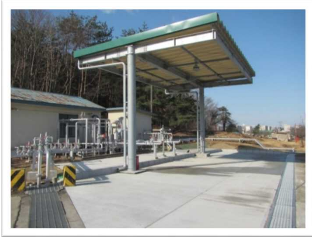
新設燃料受入施設
