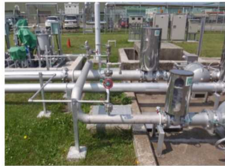
改修後燃料用配管
