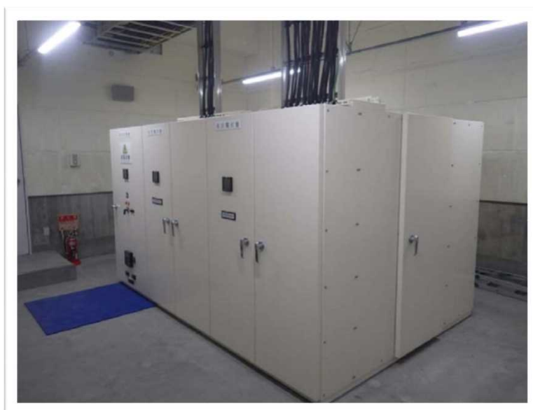
高圧受電設備
