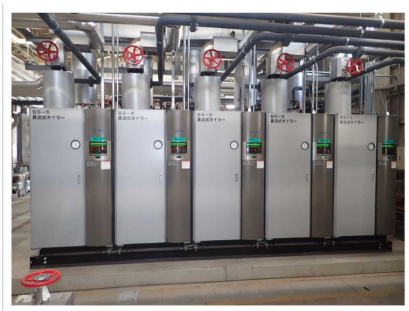
貫流式ボイラー
