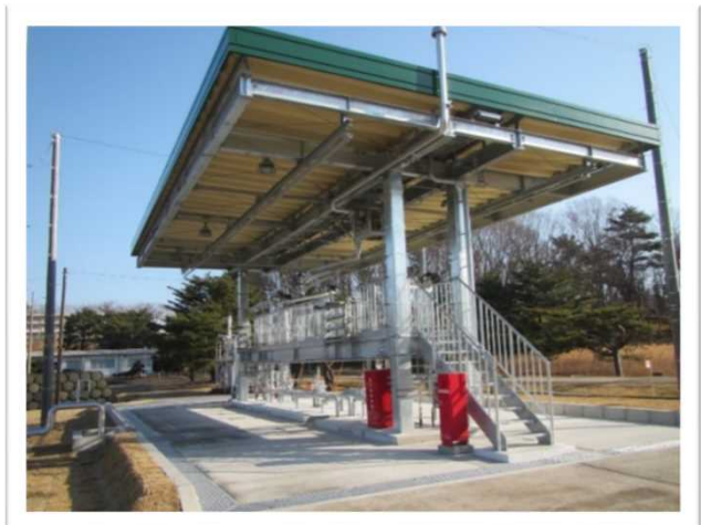
新設燃料払出施設
