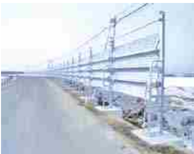
防雪柵の整備
