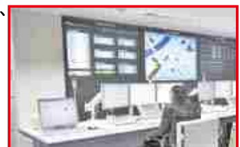
高機能消防指令センター
