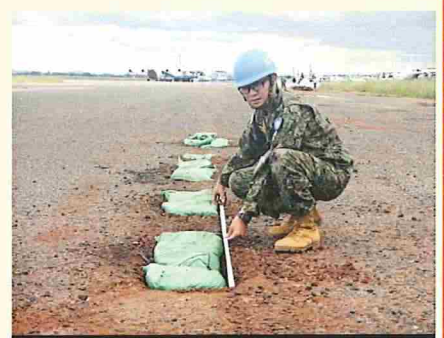
損傷した航空誘導路を調査する小山内係長
