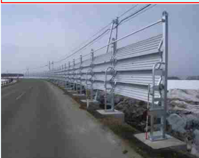
防雪柵の整備
