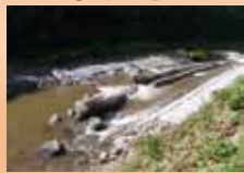
魚道上流護床損傷
