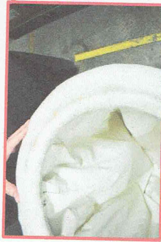
腰部分フレーム折損
