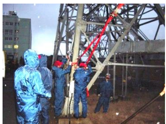
↑ ボイラー煙突倒壊の応急措置をする隊員
