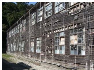
↑ 老朽化が進んだ倉庫
