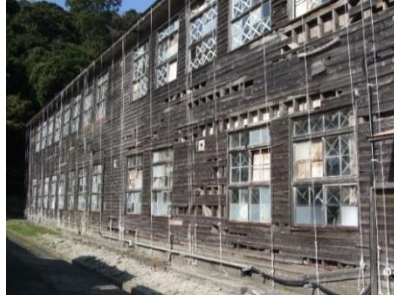
↑ 老朽化が進んだ倉庫
