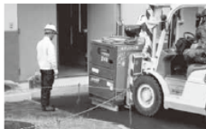
隊員食堂電源切替盤への発電機繋ぎ込み
