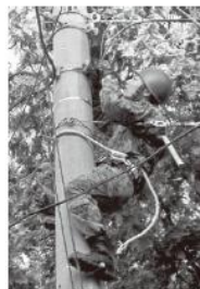
部隊の要望により通信回線の構成及び電話機を設置する隊員
