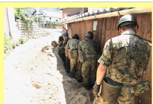
安浦地区応急復旧（8偵）
