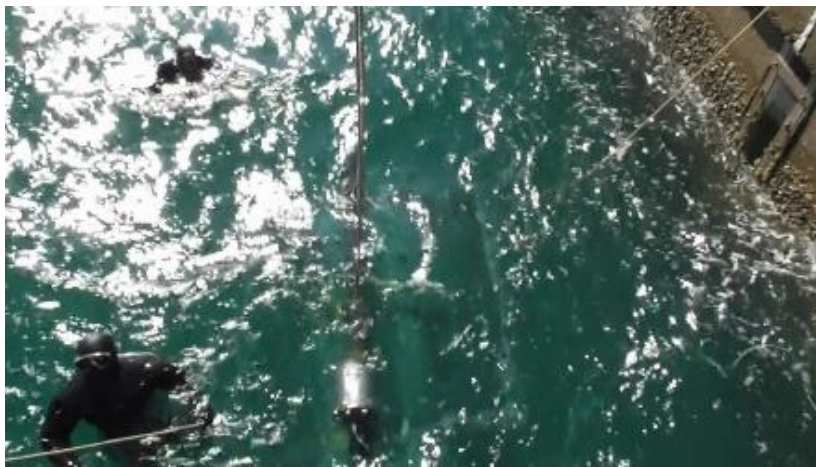
図 3.4-290 送電コイル（充電スタンド）設置状態
