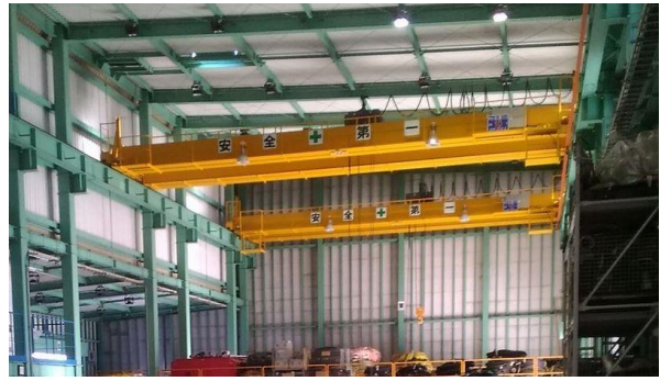
(b) 天井クレーン 2基
