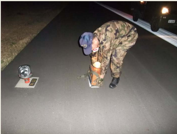
非常用滑走路灯設置
